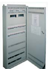
Вводно-распределительный щит с АВР
